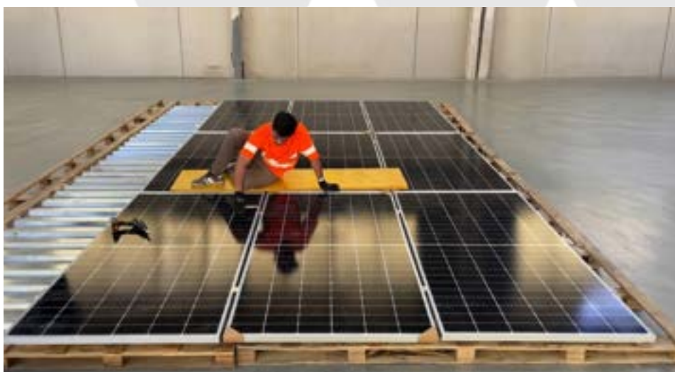
Imagen 6: CARGA DURANTE APRIETE – PROHIBIDO
