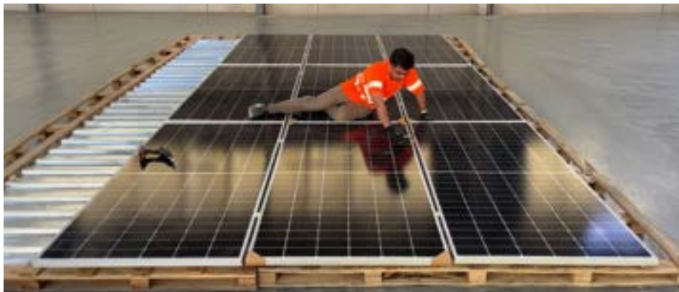
Imagen 4: CARGA DURANTE APRIETE – PROHIBIDO
