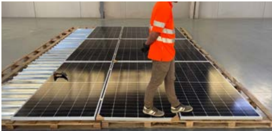
Imagen 1: TRÁNSITO SOBRE MÓDULO – PROHIBIDO
