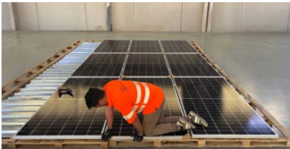
Imagen 2: TRÁNSITO SOBRE MÓDULO – PROHIBIDO
