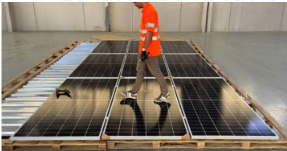
Imagen 3: TRÁNSITO SOBRE MÓDULO – PROHIBIDO
